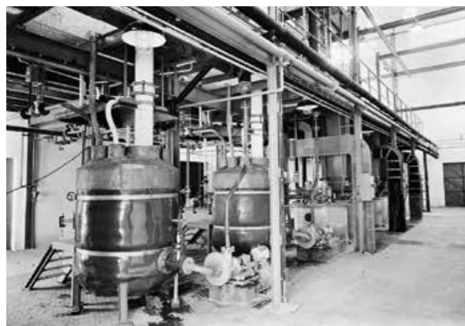
Fabricación de clorito. Reactores de generación de \text{ClO}_2 .
