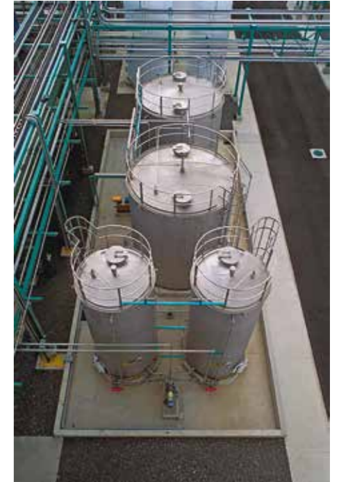
Planta de agua oxigenada.
