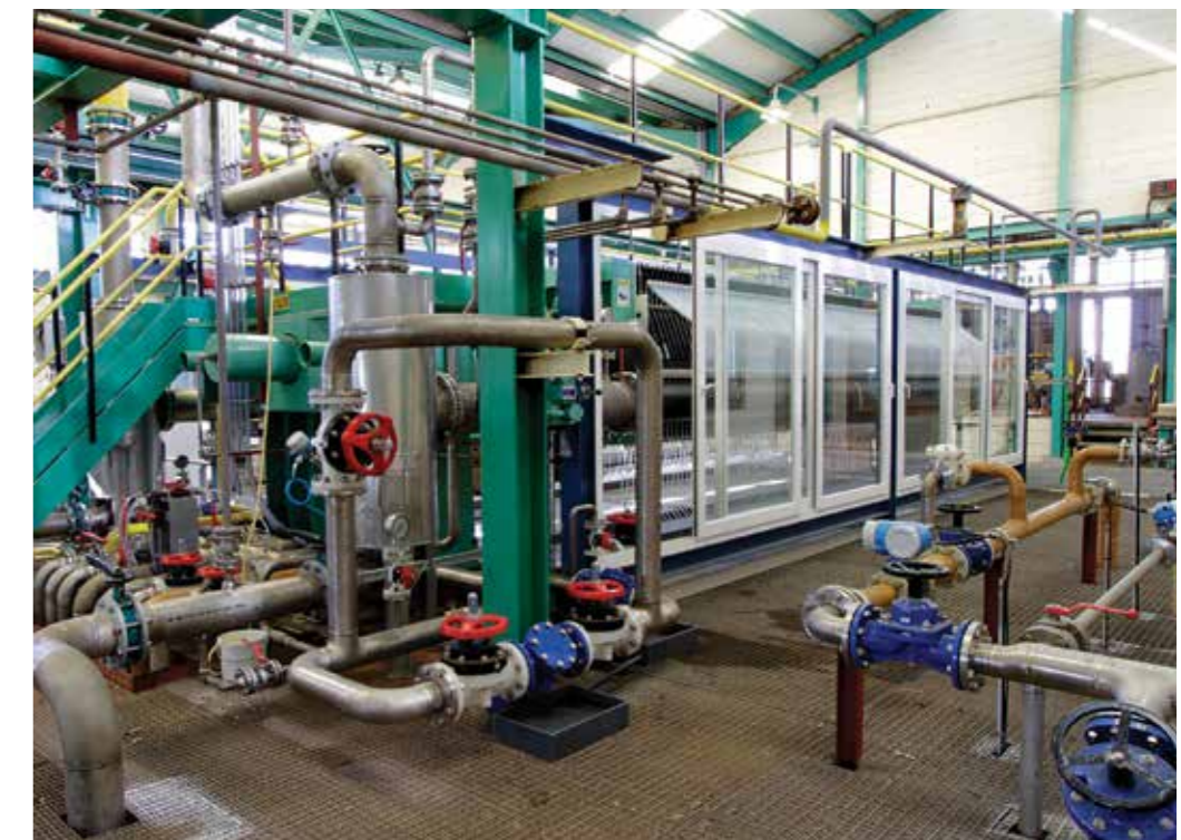
Electrolizador de cloro sosa. Puesta en marcha el 8 de febrero de 2018.
