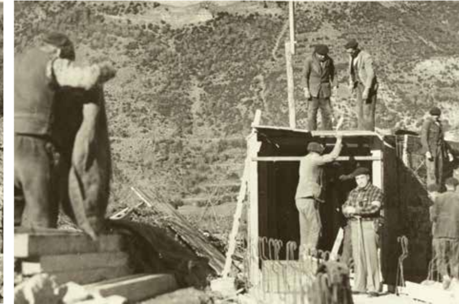
Los trabajos de reparación del canal, sobre estas líneas, se alargaron durante dos meses y no se dieron por terminados hasta febrero de 1937.
