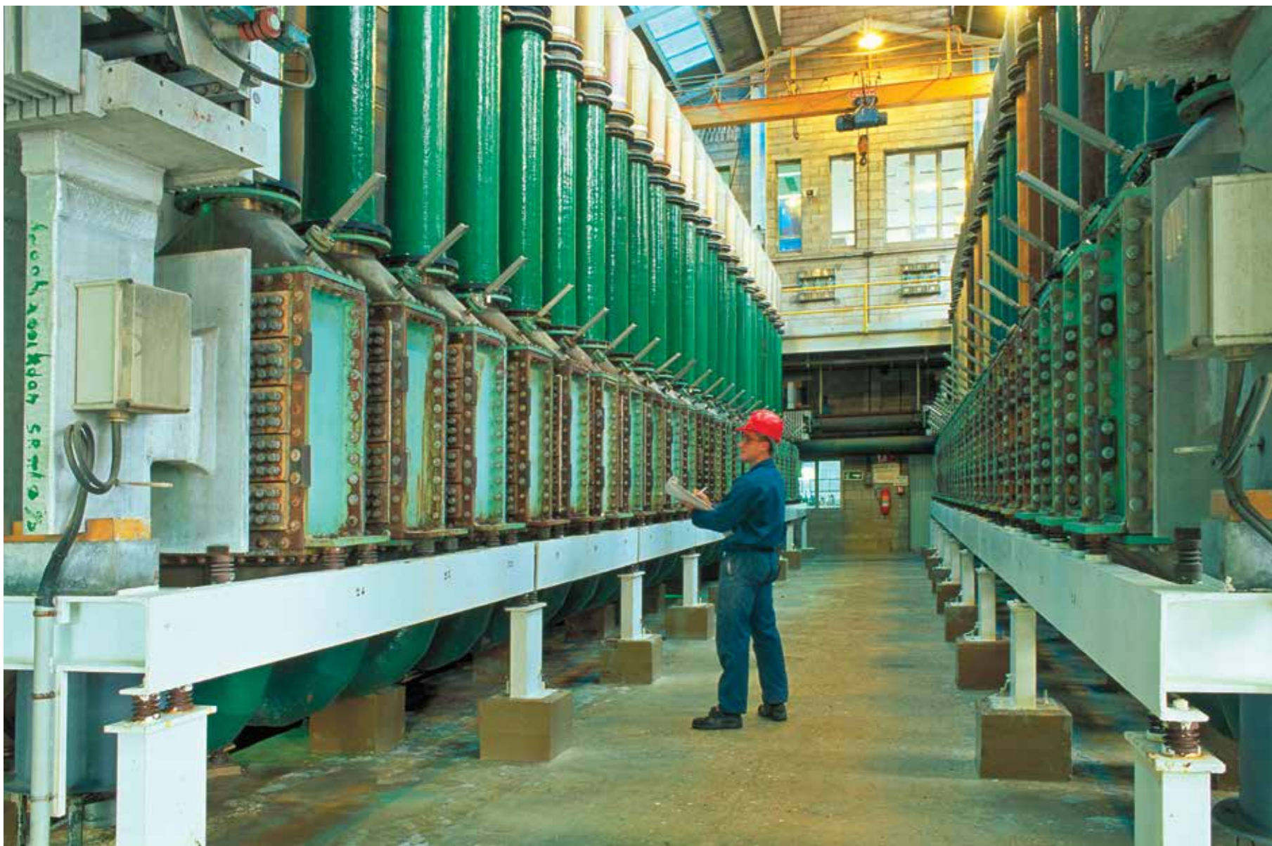
Fabricación de clorato.
